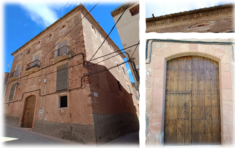
Cal Coco: Vista de la façana. Detall del ràfec de pedra i tortugada (superior) i portalada de la casa (inferior).
